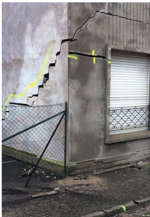
Fissures suite à un retrait gonflement d'argile.
